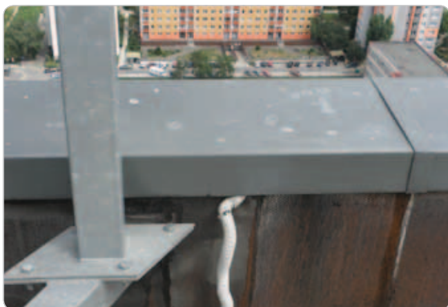
Obr. 8 Zvod prechádza popod atiku a je v horľavej PVC rúrke. Nie je dodržaná dostatočná vzdialenosť s , hrozí preskočenie blesku na nechránené časti.
