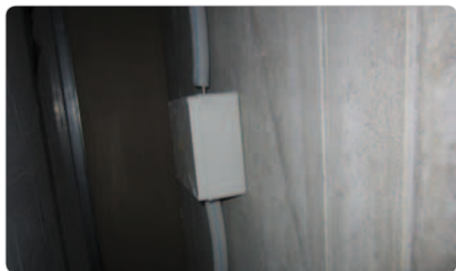
Obr. 2 Neprístupná skúšobná svorka č. 1
